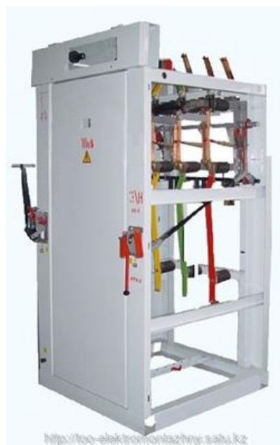
Рисунок 1.4 - Щитовое оборудование 6-10 кВ
