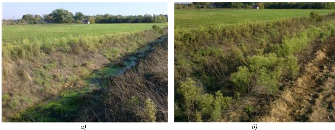
Рисунок 2 – Состояние канала: а) наносы в канале; б) растительность в канале
