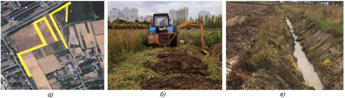
Рисунок 21 – Очистка каналов Полевой опытной станции каналоочистителем ОКН-0,5 с модернизированным ковшом: а) схема участков очищенных каналов; б) каналоочиститель ОКН-0,5 в работе; в) очищенный канал
